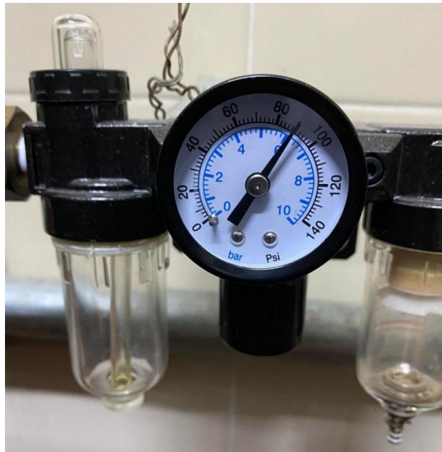
Figura 1. Barómetro del flujo de aire de la evaporadora.
