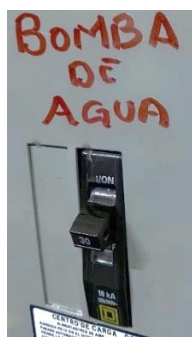
Figura 18. Interruptor de la bomba de agua.
