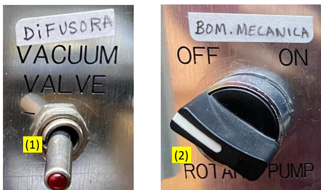
Figura 16. Interruptores de la difusora (1) y la bomba mecánica (2), respectivamente.
