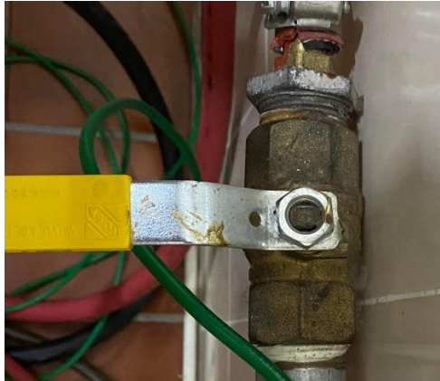
Figura 19. llave de paso del agua (amarillo)
