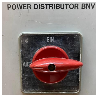
Figura 20. Interruptor principal de la evaporadora.
