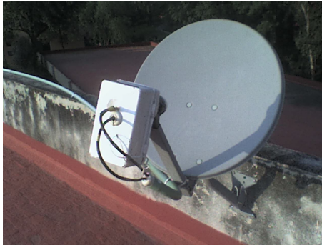
Figura 4.7: Antena parabólica de 0.60 m de foco desplazado, con receptor LNB y oscilador local de 10835 MHz.
